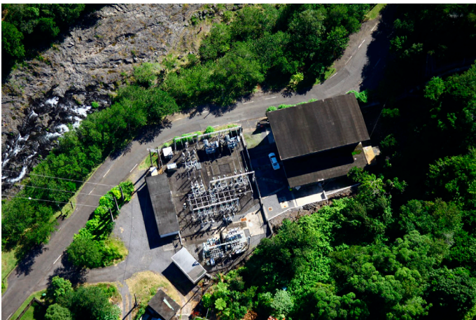
Ouvrage de prise d'eau hydroélectrique de la rivière Langevin Photo : Raphaël LAGARDE
